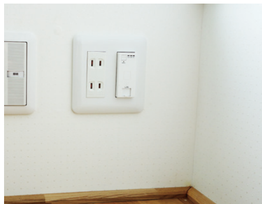
マンションのデスク横に設置された情報コンセント型無線LANルータ
