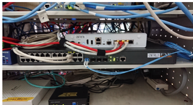
サーバ室に設置された L3 スイッチ「FXC9324XG」
