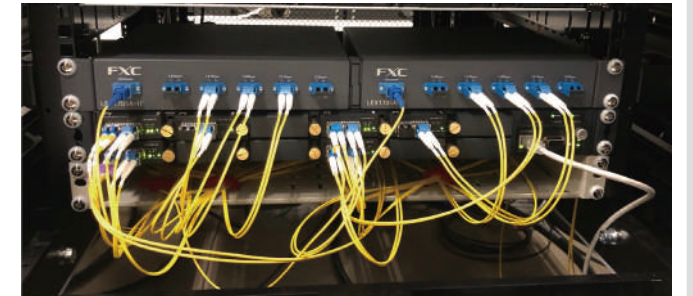
サーバールーム
