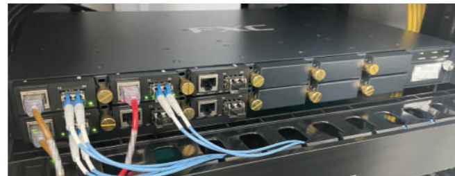
サーバールームに設置された「LEX1012-15」、「LEX1851-1F」
