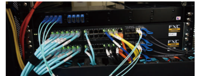
サーバールームに設置された「FXC9432」
